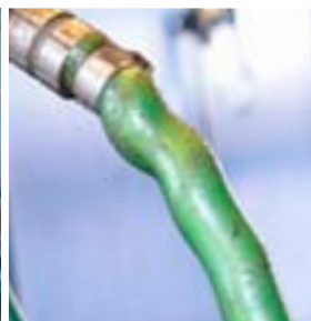
Vecchi attacchi con fascette stringitubo che provocano perdite e cadute di pressione
